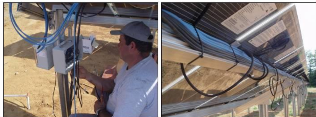
Figure 36- Mise à la terre (protection directe) – Source : Valeco
