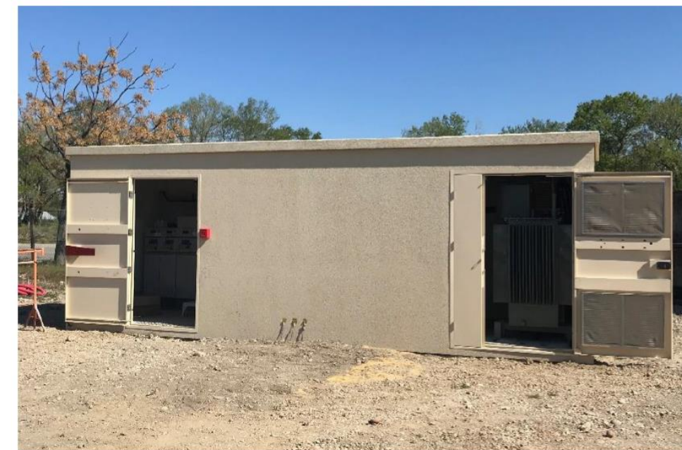
Figure 23 : Photographie d'un poste de livraison/transformation – Source : Valeco
