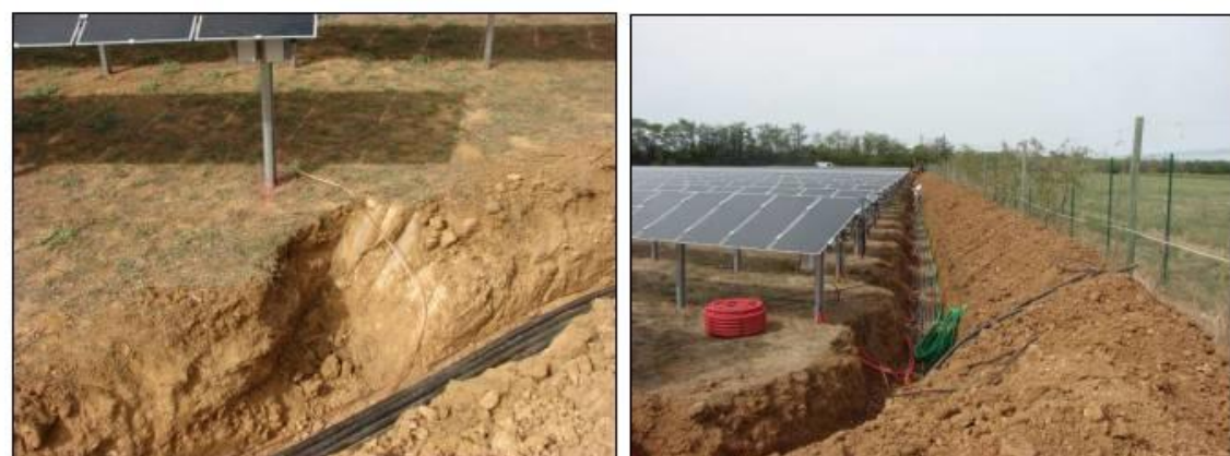
Figure 37- Tranchée drainant le courant continu – Source : Valeco
