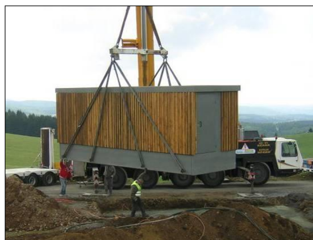
Figure 38- Exemple de livraison d'un poste de transformation – Source : Valeco
